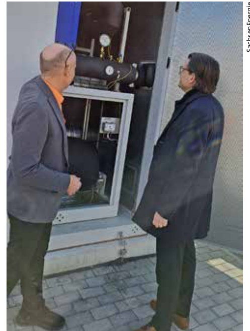
Die Experten von SachsenEnergie, Sven Wegeleben (l.) und Vorstand Dr. Axel Cunow, werfen einen Blick in die Wärmepumpe in Friedrichstadt.
